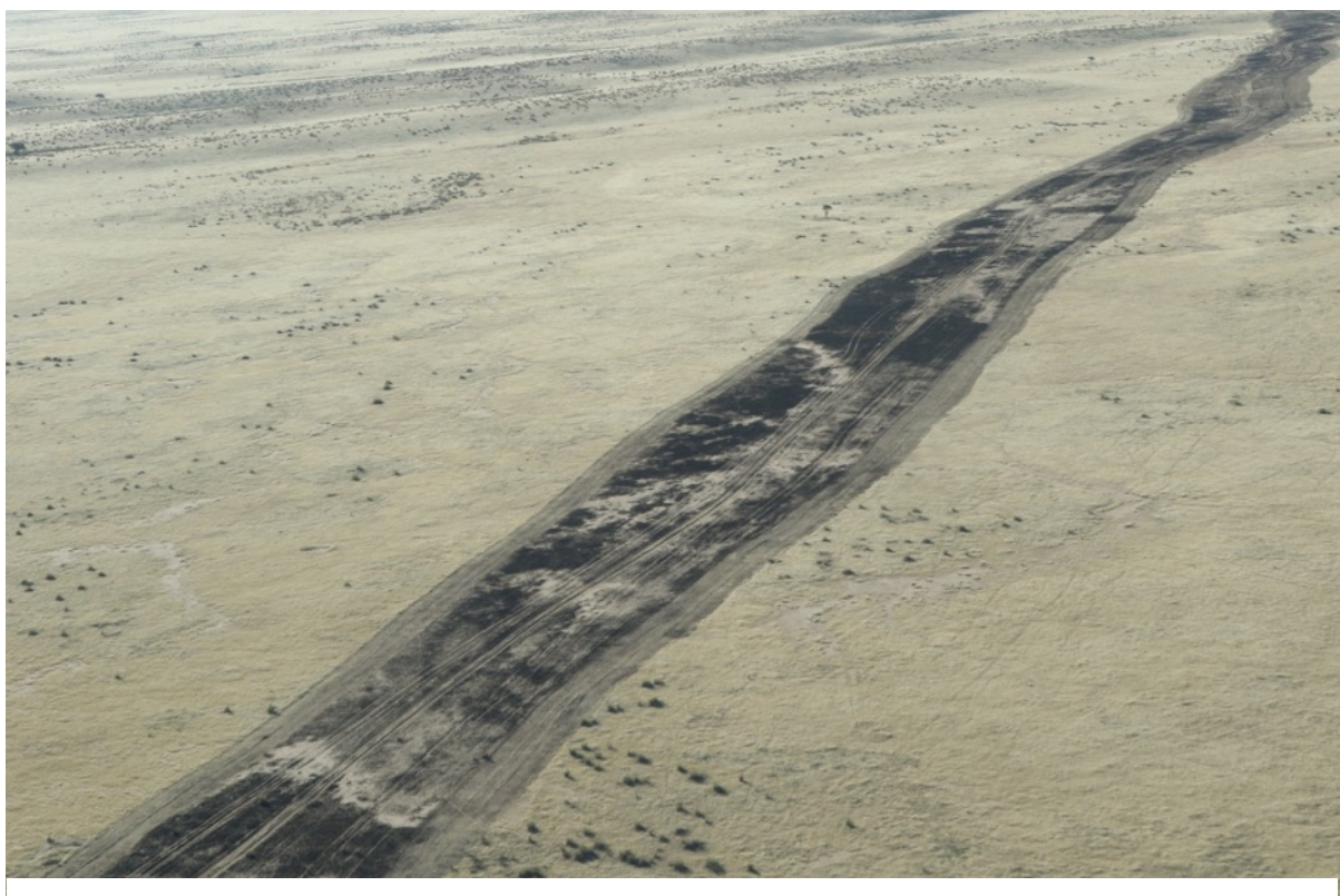
Photo 7. Détail du pare-feu ; les bandes sont d'abord hersées sur les bords extérieurs à l'aide de tracteurs fournis par le ministère de l'Environnement, avant de procéder à un brûlage contrôlé entre les deux.
